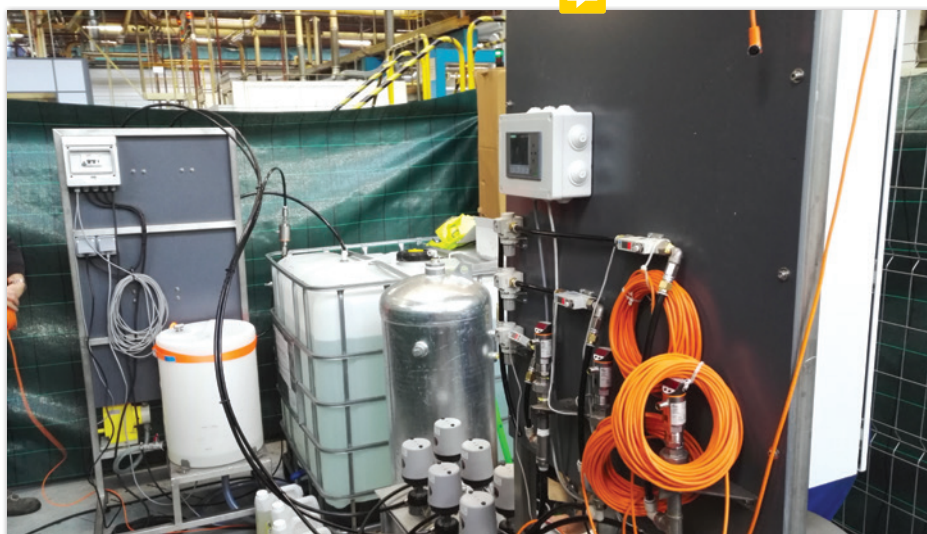
Unité d'injection de mousse de blocage.
